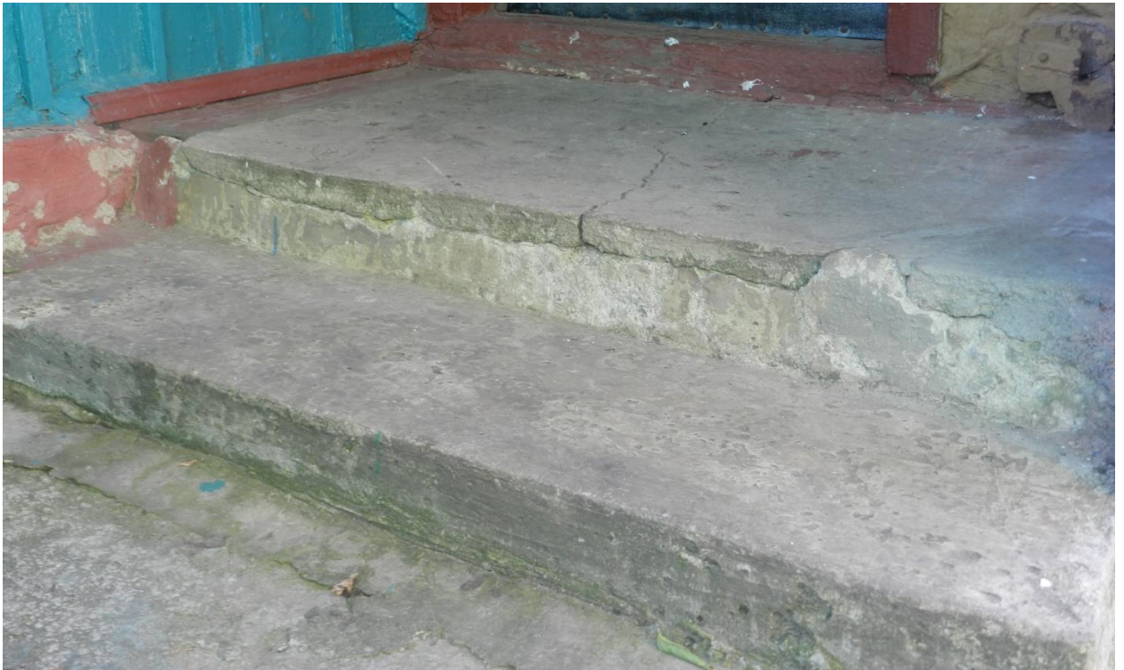
Рис. 9 Трещины и выбоины на ступенях крыльца
