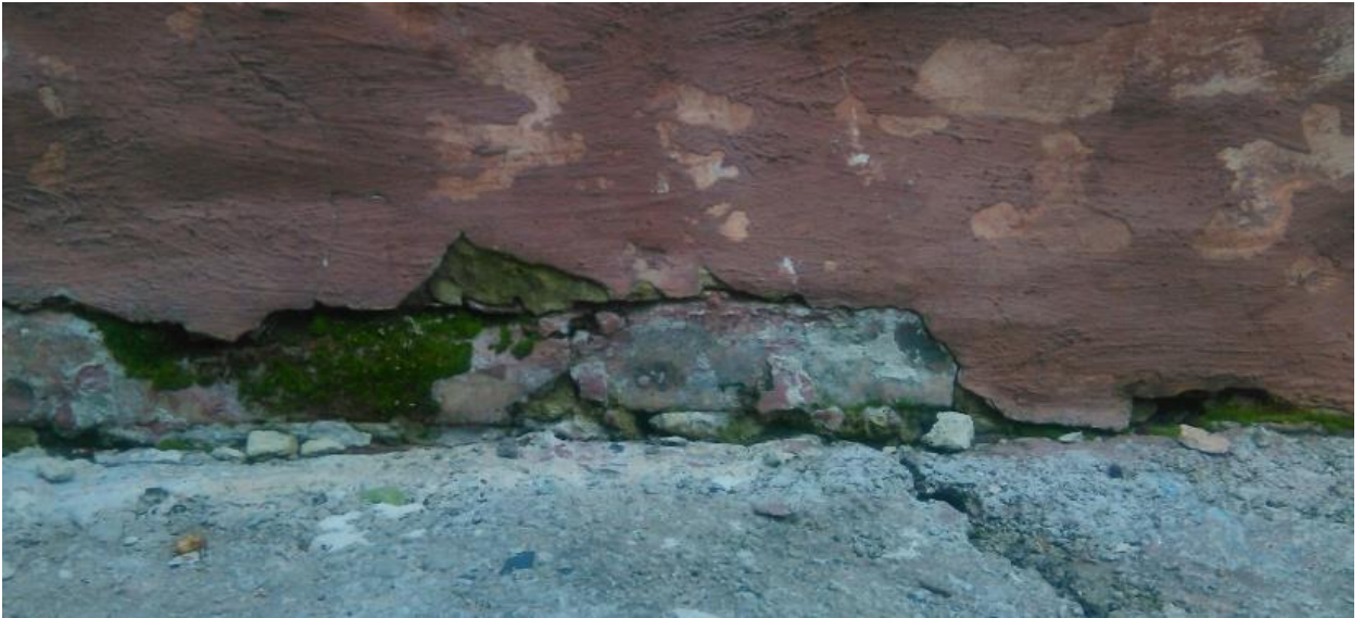
Рис. 1 Искривление горизонтальных линий цоколя и обрастание мхом нижней части цоколя
