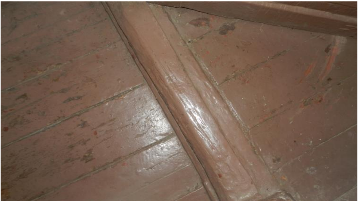
Рис. 12 Стертая краска и трещины в полах
