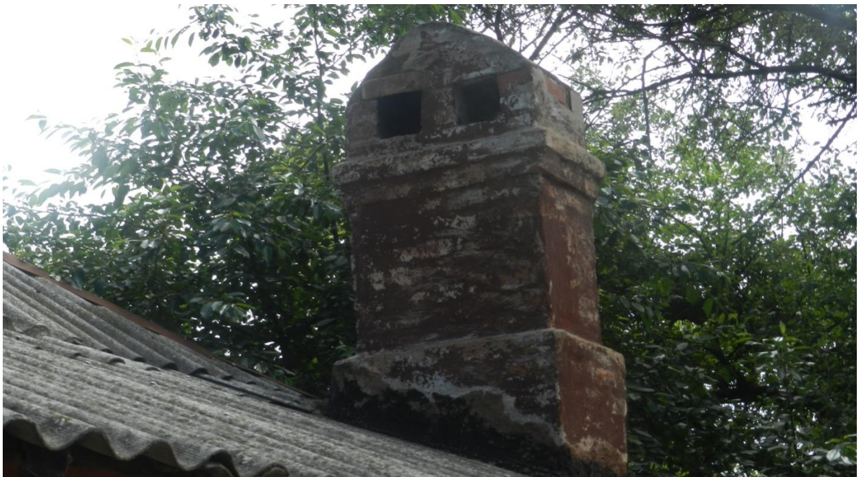
Рис. 8. Выбоины в кирпичной кладке и выгоревшая краска на дымовой трубе
