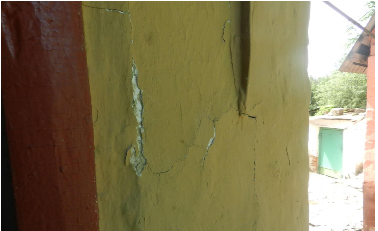
Рис. 3 Отслоение штукатурного слоя на наружной стене
