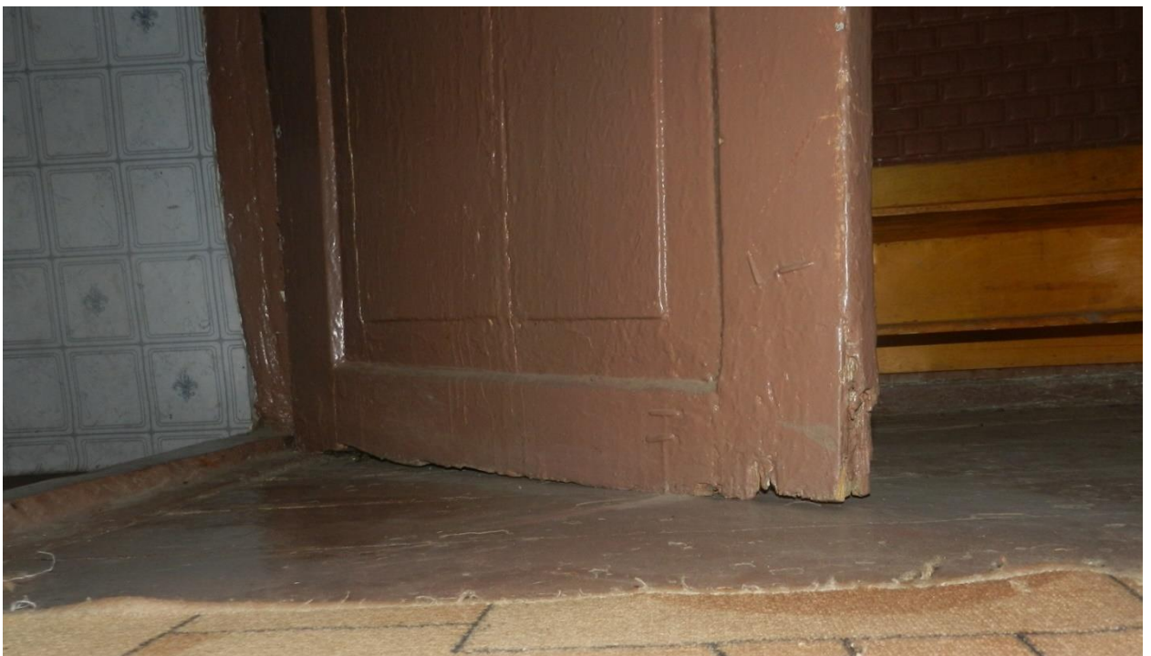
Рис. 6. Осевшее дверное полотно с повреждениями
