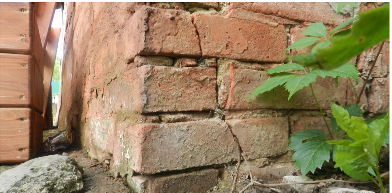
Рис. 2 Трещина в кирпичной кладке нижней части жилого дома
