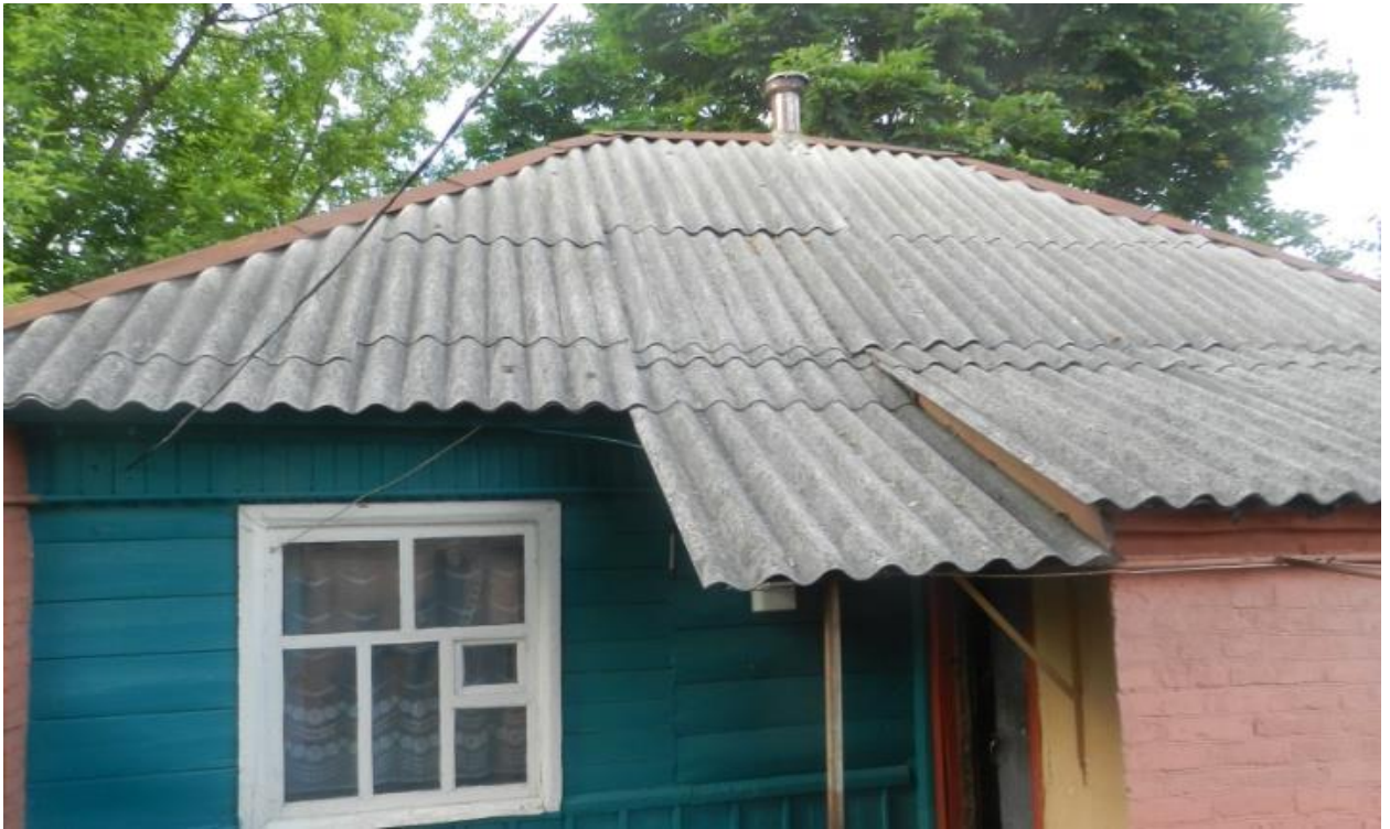
Рис. 7. Четырехскатная крыша с загрязненной кровлей
