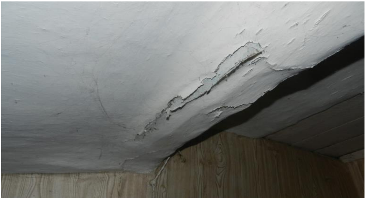
Рис. 4 Отслоение штукатурного слоя на чердачном перекрытие
