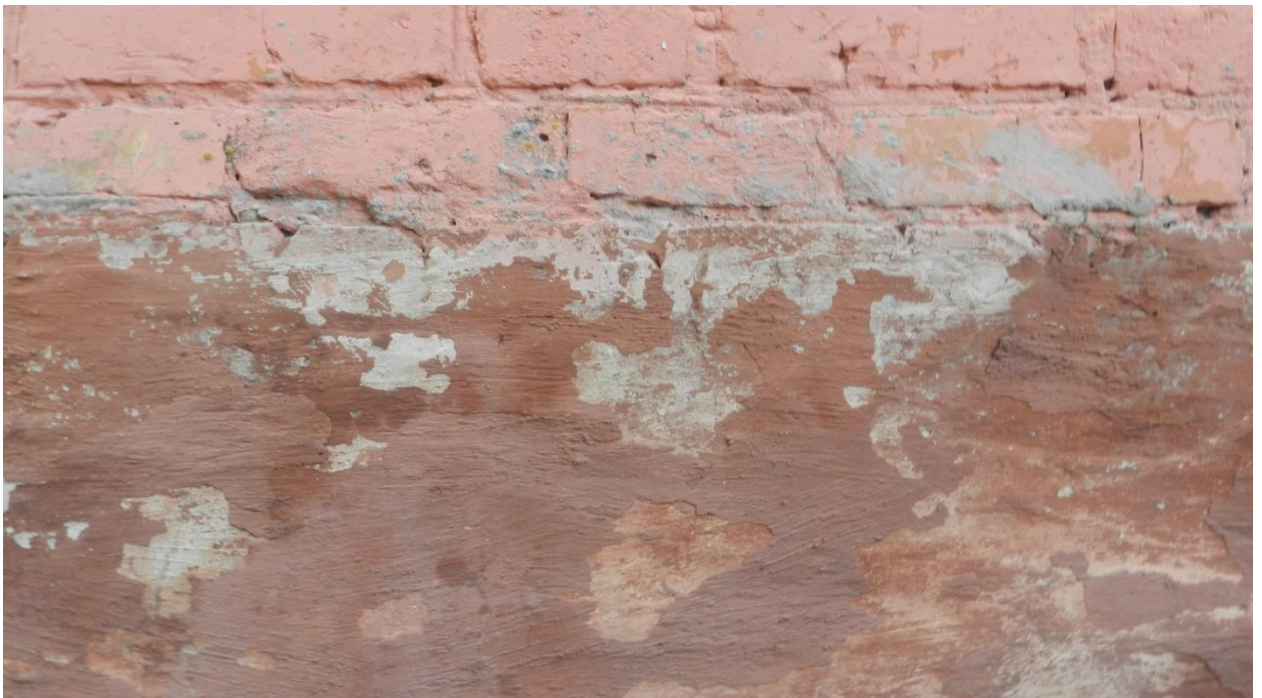
Рис. 10 Выгоревшая и стертая фасадная краска, трещины в кладке
