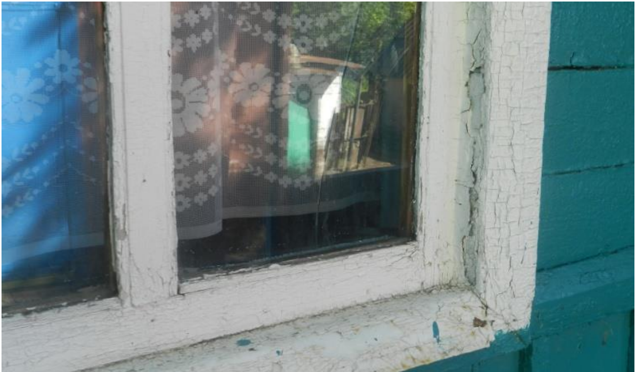
Рис. 5. Шелушение краски и единичные трещины на оконном проеме
