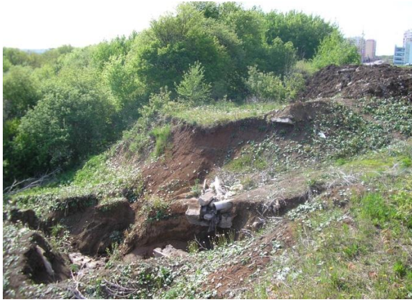
Рис. 2.10. Оползень на ул. Есенина
