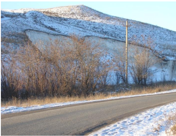
Рис. 2.12. Оползание склонов вдоль автотрассы Белгород-Валуйки
