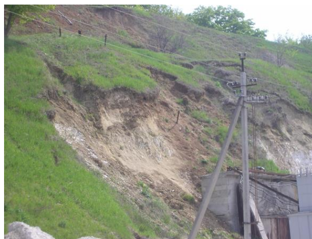
Рис. 2.9. Оползень в районе авторынка г. Белгород
