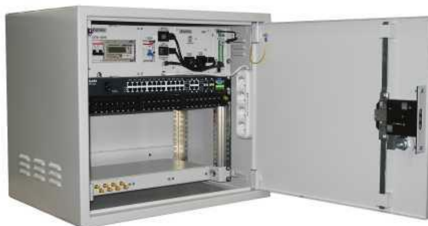
Рисунок 4.7 – Размещение оборудования в антивандальном шкафу
