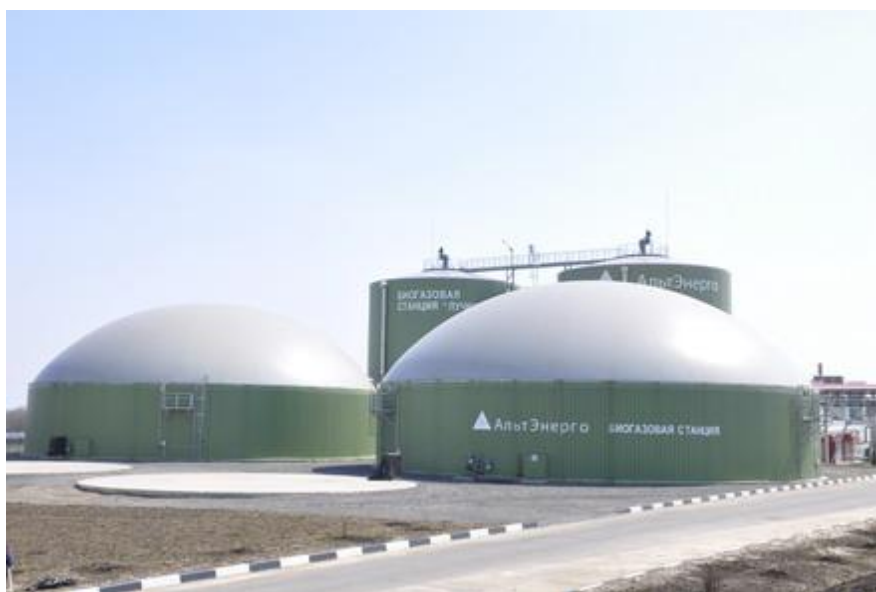
Рис. 1.2. Биогазовая станция «Лучки»
