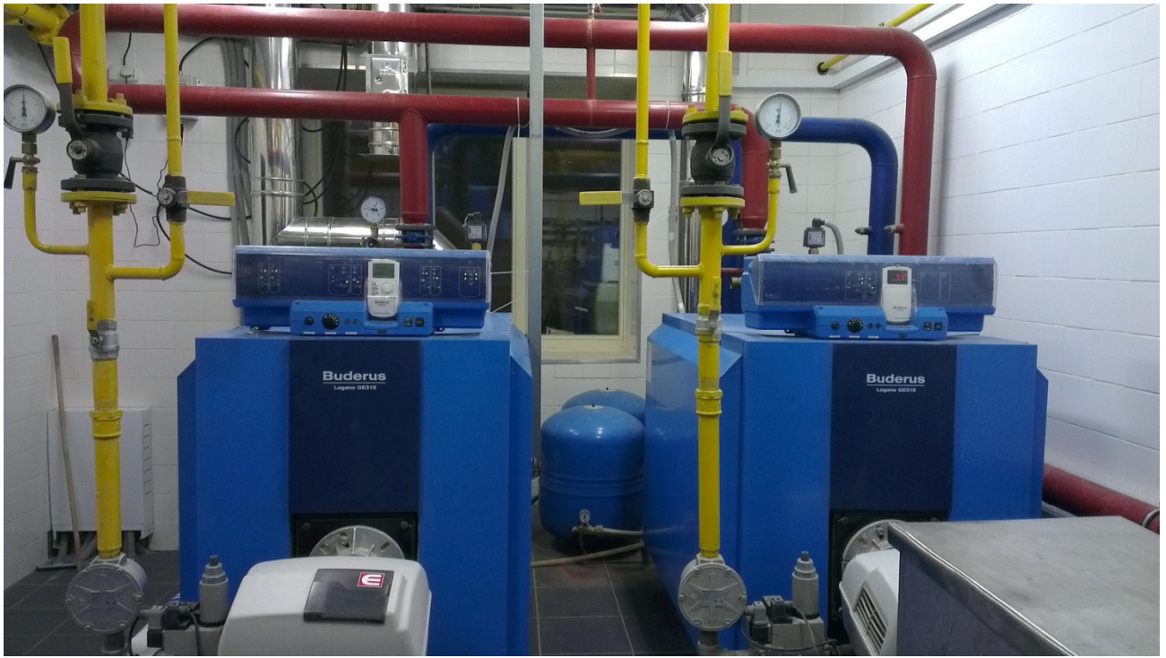
Рисунок 1.3–Котлы «Bunderus» LoganoGE315 с вентиляторными горелками «Bunderus» LogatopGZ2
