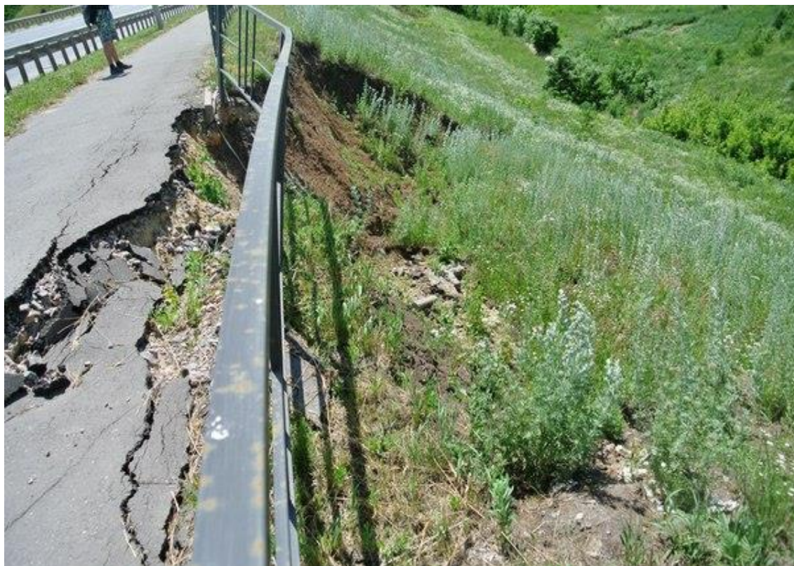
Рисунок 15 - Интенсивное оврагообразование тротуара Восточной объездной дороги (фото автора)
