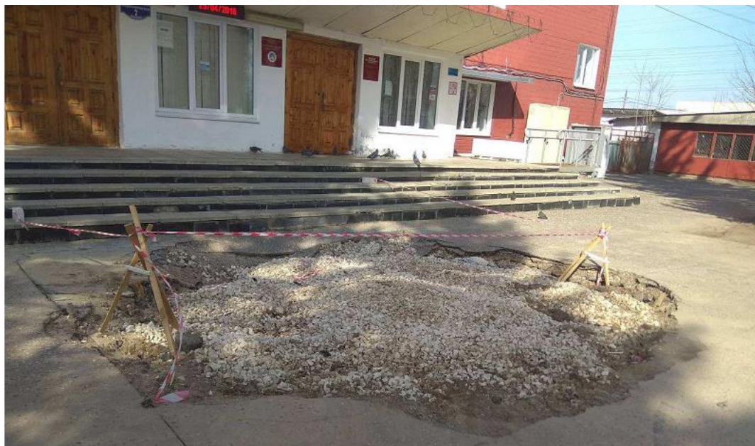
Рис. 2. Провал в ключевой зоне контроля Fig. 2. Failure in a key zone of control
